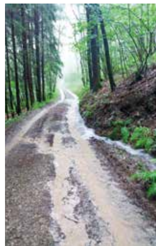
Unkontrollierter Wasserabfluss. © LP
